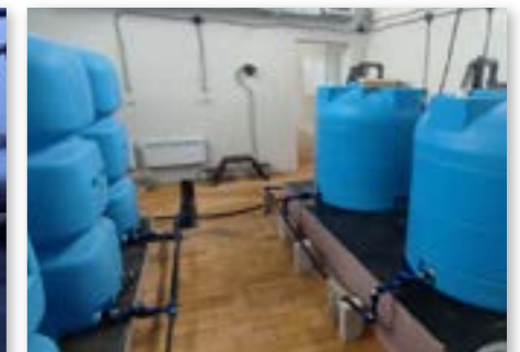
Насосная станция, г. Елец
