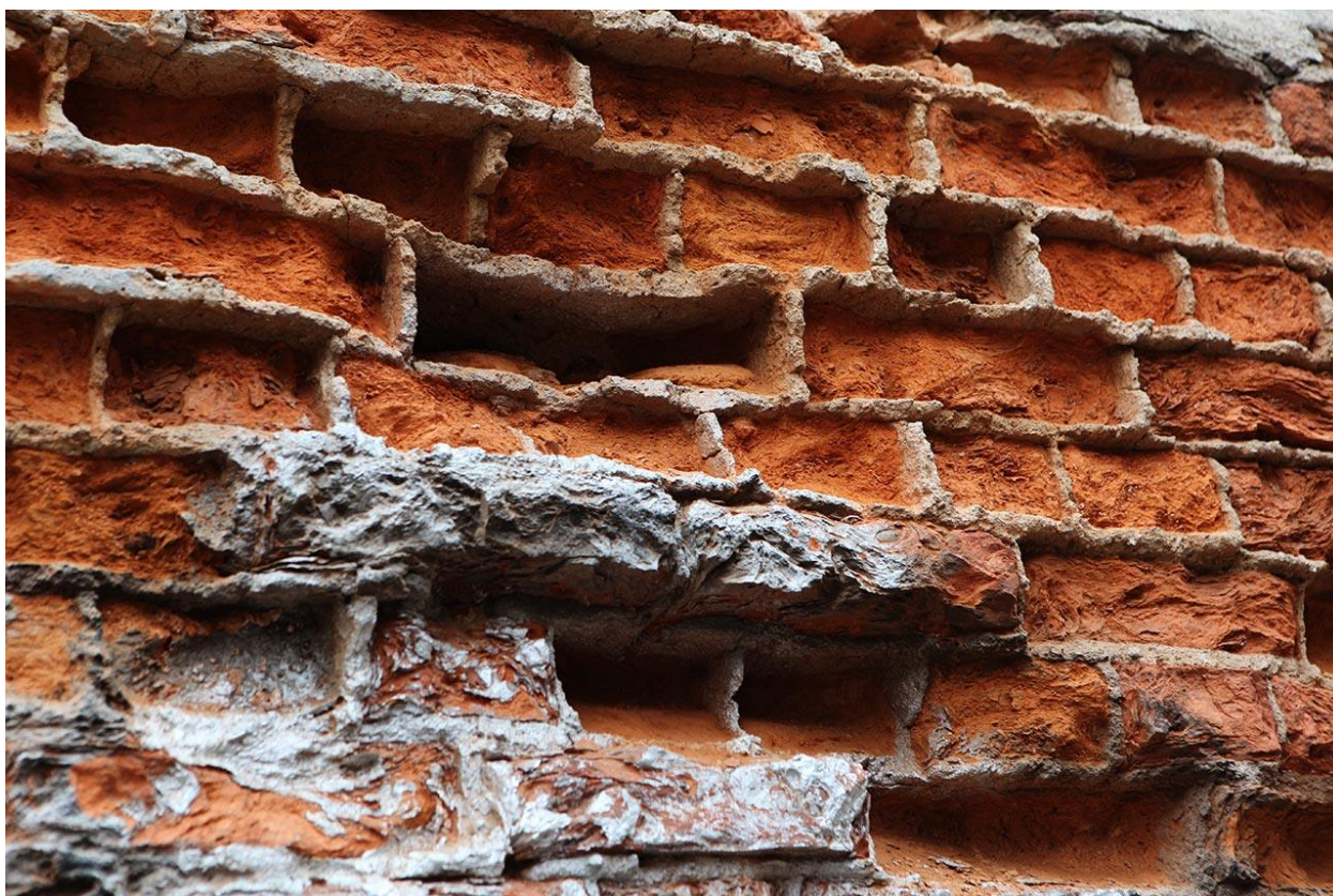
Рисунок 7.48 – Разрушение кирпичной кладки
