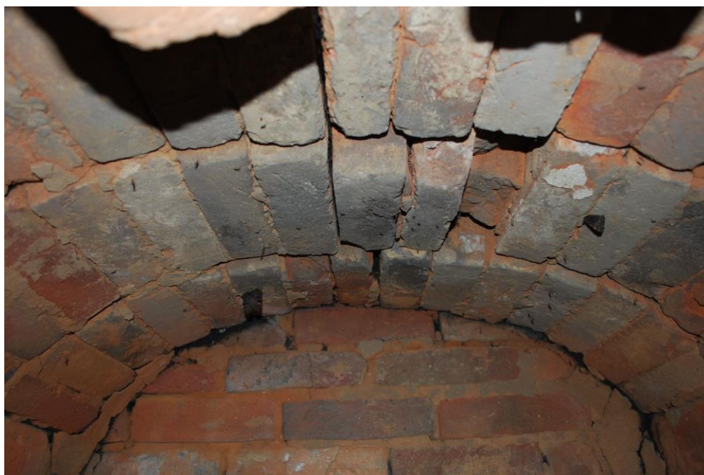
Рисунок 7.56 – Выпадение камней из кирпичной кладки сводов
