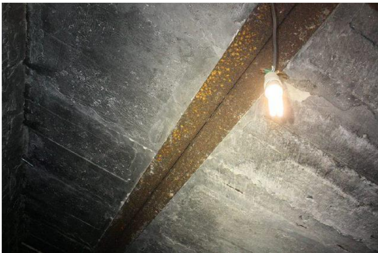
Рисунок 7.50 – Коррозия балки перекрытия
