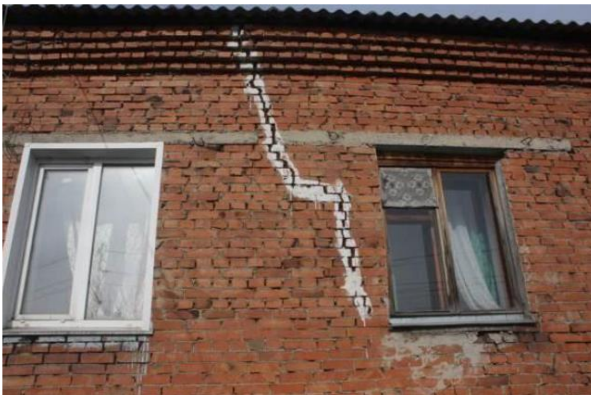
Рисунок 7.5 – Трещина в кирпичной кладке.
