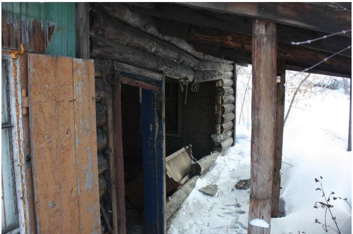
Рисунок 7.3 – Физическое отсутствие наружного простенка.
