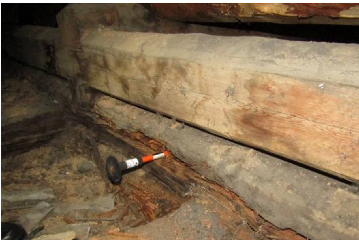
Рисунок 7.49 – Поражение гнилью деревянной стены
