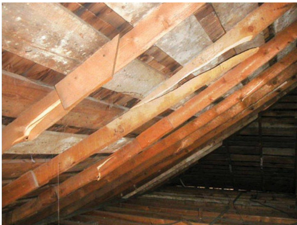
Рисунок 7.6 – Трещины в деревянных стропилах.
