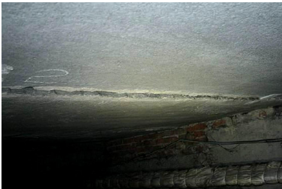
Рисунок 7.28 – Прогиб ж/б плиты перекрытия.
