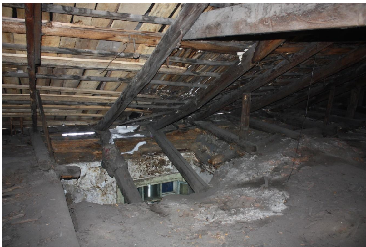
Рисунок 7.41 – Потеря устойчивости стропильной системы.
